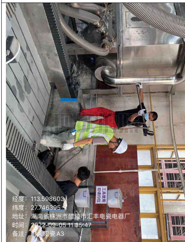
切割雕刻废气排气筒进口
