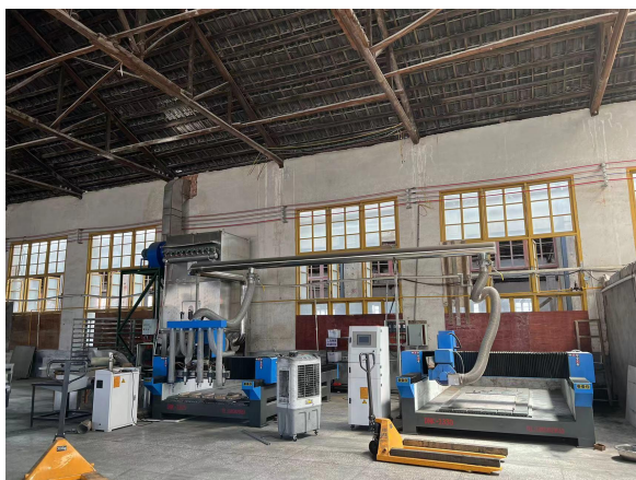
袋式除尘设施
