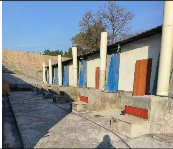
金沙塘工区水浴除尘系统
